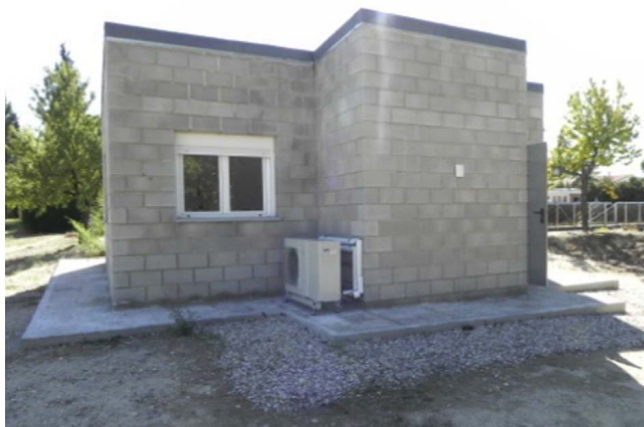
Figura 3. Bomba de calor reversible aire-agua.
