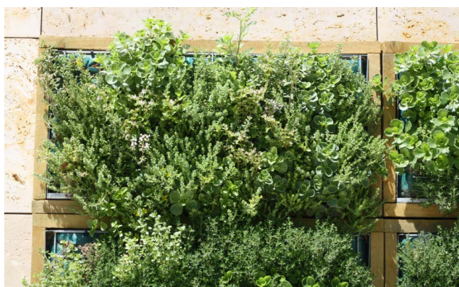
Figura 1. Imagen del muro objeto de ensayo con sistema ajardinado instalado en sustitución del revestimiento calizo
