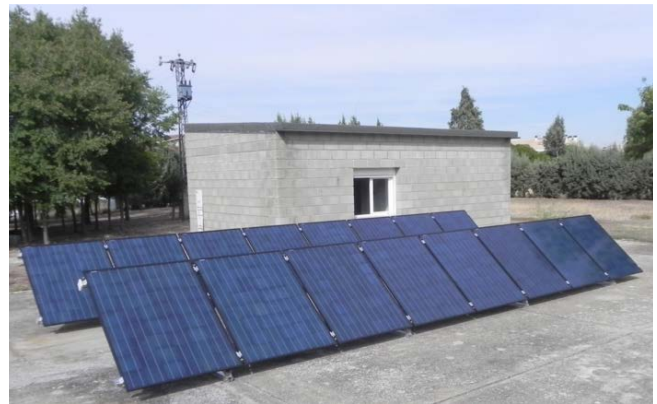
Figura 2. Campo fotovoltaico y laboratorio.
