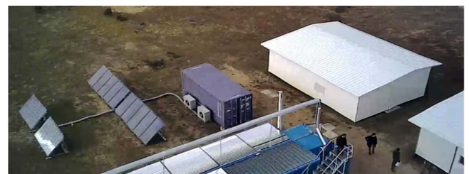
Figura 5. Vista aérea de la Isla Energética
