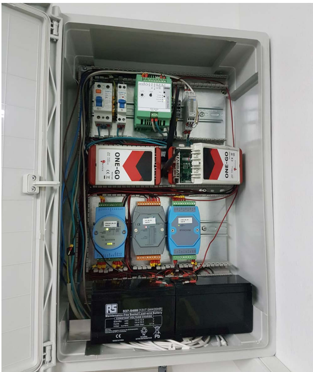
Figura 1. Cuadro de monitorización tipo.
